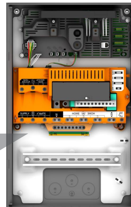
Backup Gateway内部
